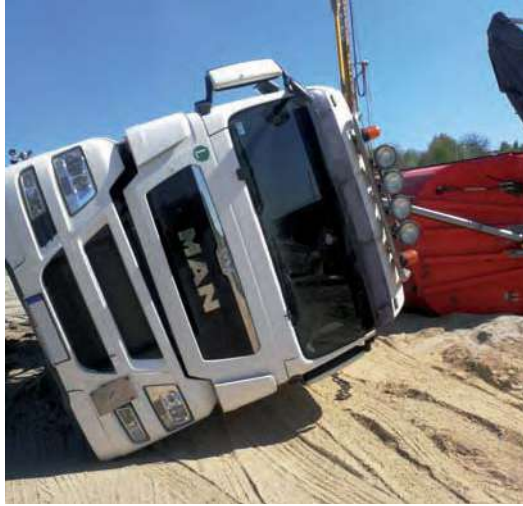
Rys. 4.1. Przewrócony pojazd wskutek nieoznakowania strefy bezpiecznej pracy na platformie roboczej
